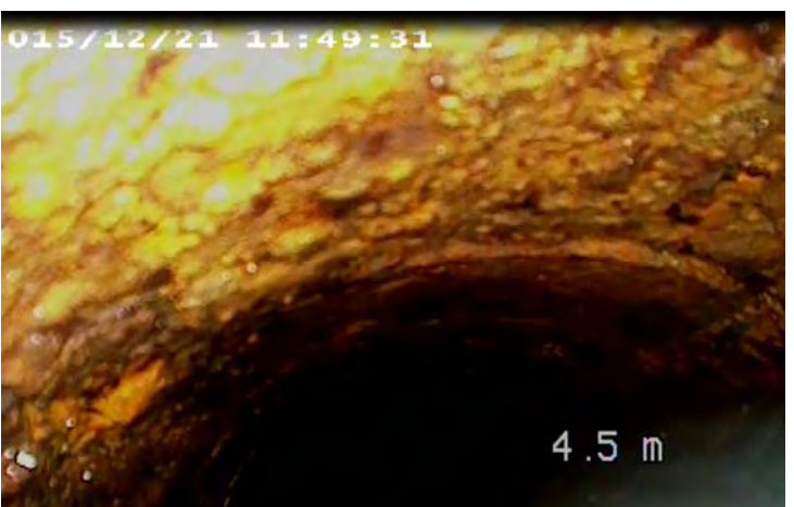
Efter ca 4,5 m ser vi en tydlig kant. Vi tolkar det som skyddsrörets slut.
