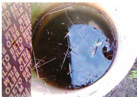
Grävd brunn med döda råttor på grund av otätt lock.
