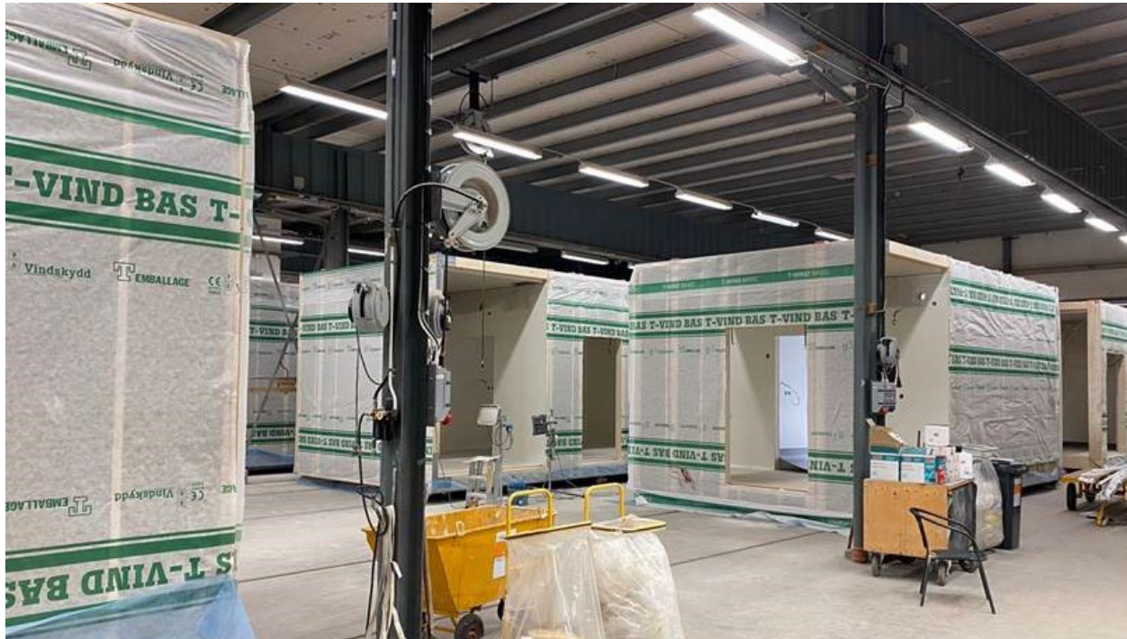
Inrednings-line fullbelagd med Visby-moduler
